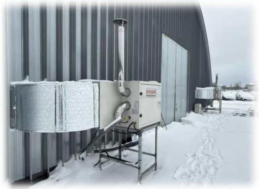
项目机组近景场景
