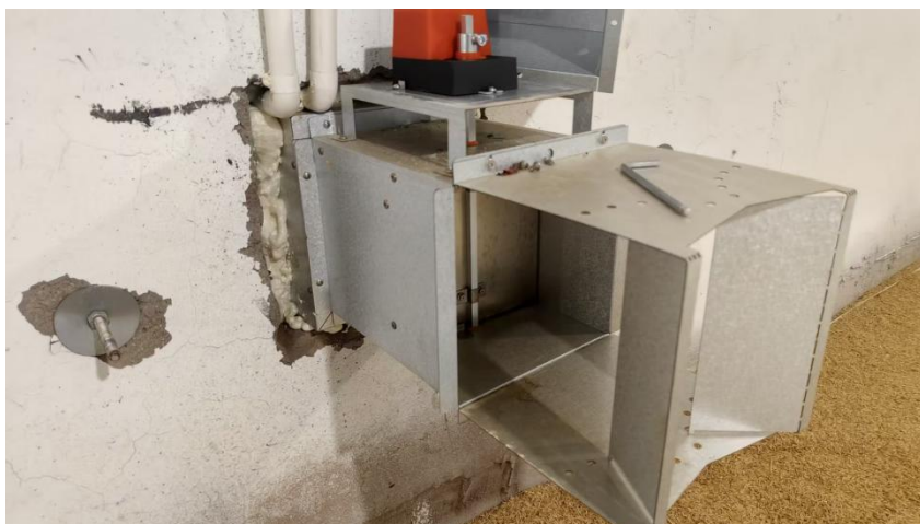
室内热风送风口
